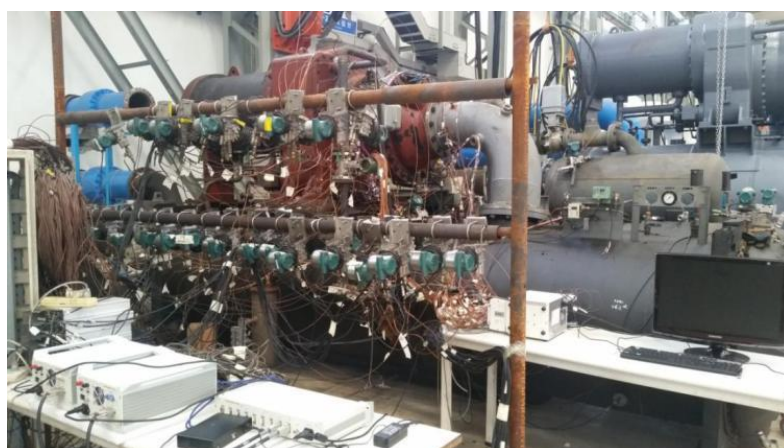
图 2 冷水机组外部测试仪表及接线
